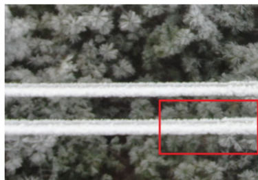
图4 局部覆冰厚度不均匀图像
