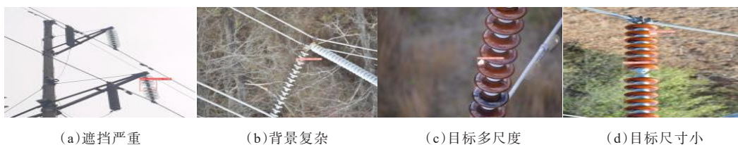
图 26 YOLO-insulator 的检测可视化图像
