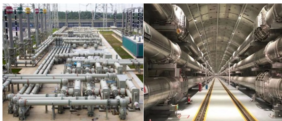
图 1 1 100 kV GIS 和 1 100 kV GIL
